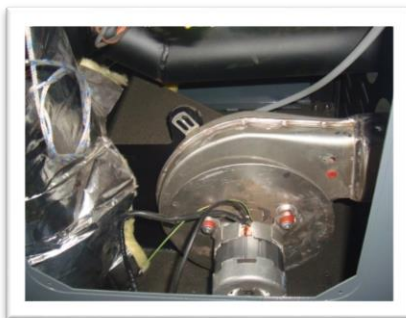
Ventilatorul și senzorul de temperatură gaze fum
